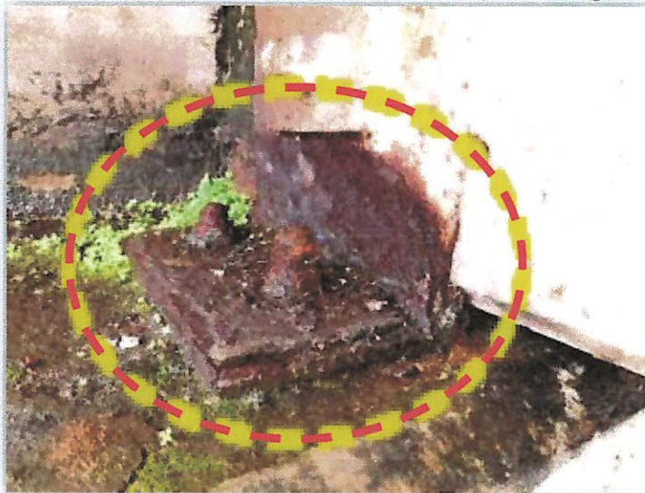
Fotografía 8. Vista de las condiciones actuales de elementos no estructurales del paso a desnivel Ing. Enrique Tejada Wyld, atribuidas a la antigüedad de la construcción y falta de mantenimiento.
