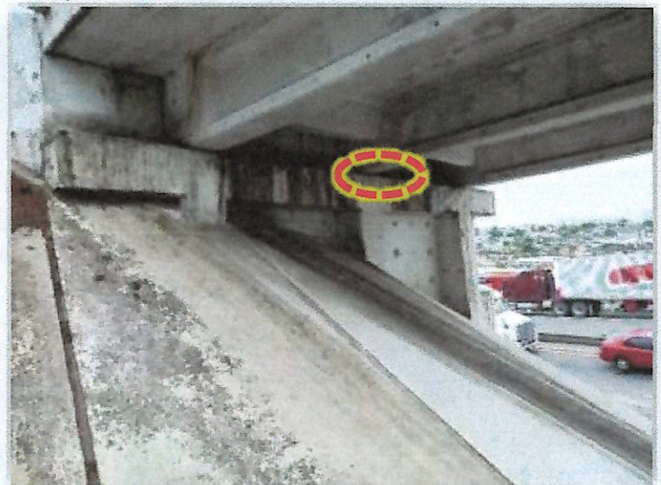
Fotografía 9. Vista del área del estribo (lado norte del puente) que evidencia de deterioro de la almohadilla de neopreno.
