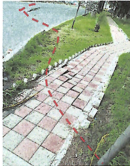
Fotografía 8. Vista del caminamiento en área verde donde se extiende la grieta.
