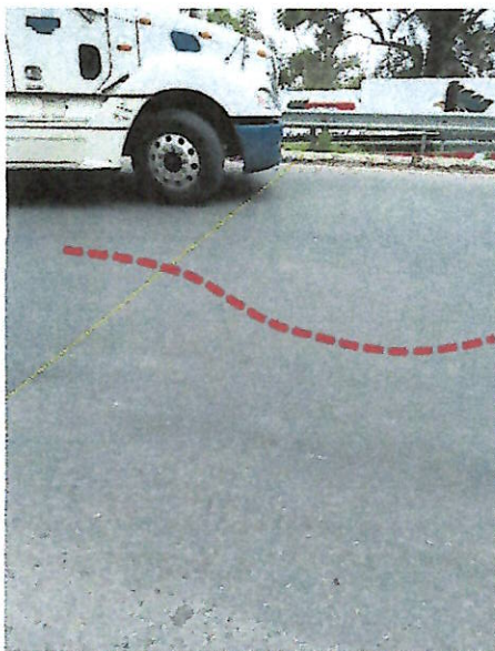
Fotografía 9. Vista de deformación en la carpeta de rodadura en el carril de retorno del paso a desnivel.
