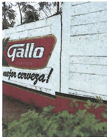
Fotografía 10. Vista de desplazamiento en junta de muro perimetral de predio de Cervecería Centroamericana.
