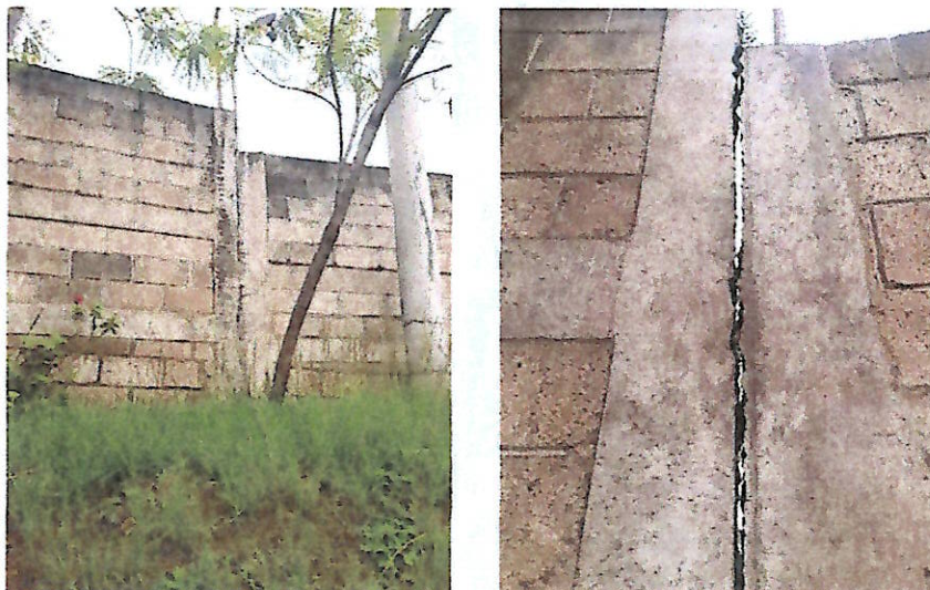
Fotografías 13 y 14. Vista de desplazamientos laterales y asentamientos identificados en muros perimetrales del predio de la Cervecería Centroamericana.
