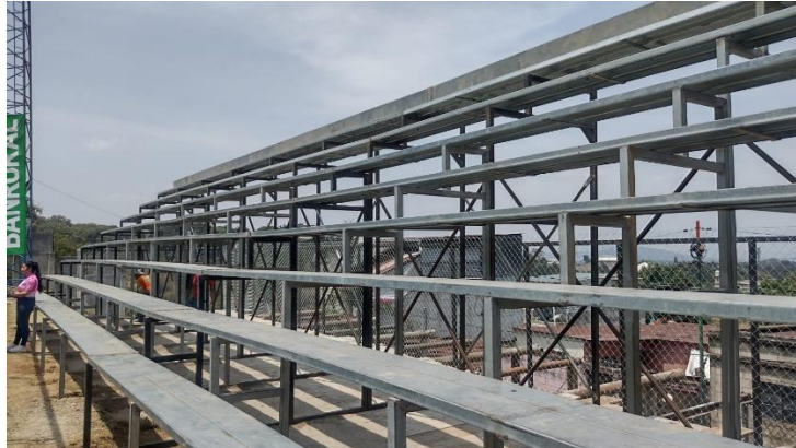
Figura 8: visualización de las dimensiones de las estructuras metálicas implementadas.
