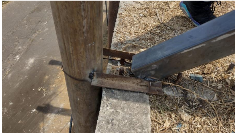
Figura 6: Deficiencia en soldadura de elementos.
