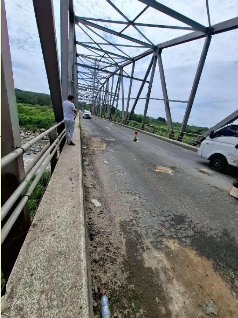
CARPETA EN MAL ESTADO
