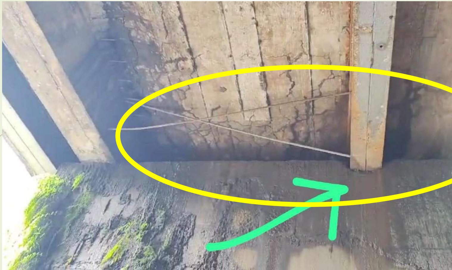
Viga y losa completamente falladas, muro Oeste, Reu
